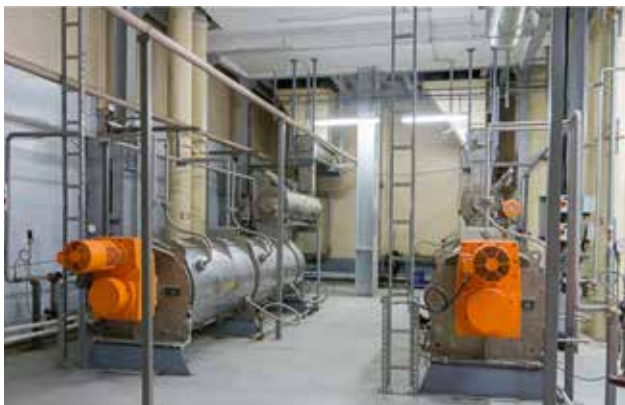
Кондиционирование и термообработка 2 x 20 т/ч Conditioning and hygienisation 2 x 20 t/h
