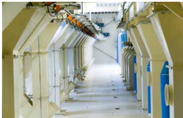
Транспортное оборудование и пневматические задвижки Conveyor equipment and pneumatic slides
